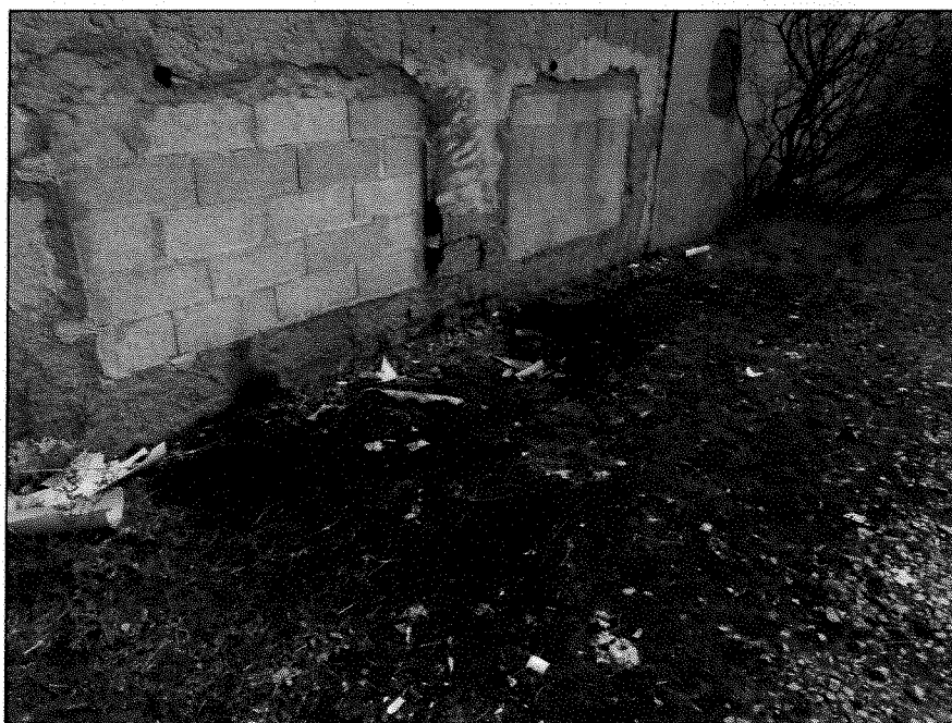
Traces noires le long du mur
